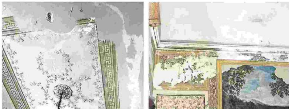
LE CRITICITÀ Macchie di umidità e infiltrazioni sugli affreschi da poco restaurati nel real sito di Carditello
