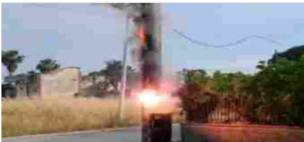
Video. Mondragone. Incendio di una cabina elettrica. Sul posto i Vigili del Fuoco
